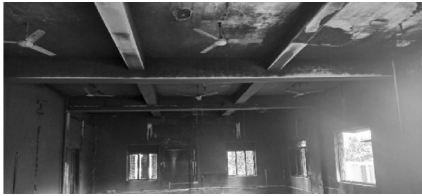
धनपालथान गाउँपालिका को क्षतिग्रस्त सभाहल
